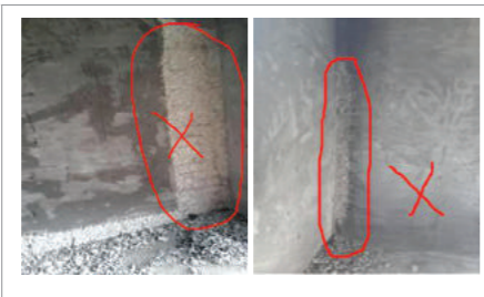
抹灰之前,应先把基层界面处理平整,要凹补凸凿,等抹完再去修,费工又耽误进度
